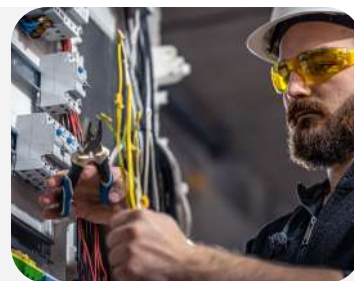
Técnico en inversores y aire acondicionado
